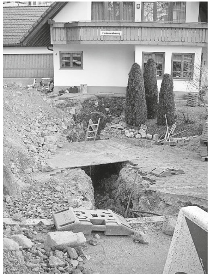
Rohrbruch im Kurparkweg
