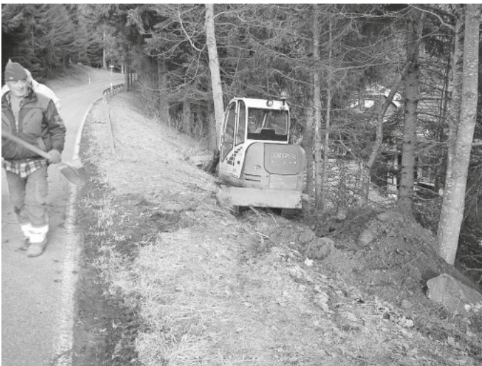
Rohrbruch Prestenberg, Bernauer Straße vom 15.-16.01.2020, Quellleitung! Hier ging fast die gesamte Quellschüttung der Prestenbergquellen 1- 3 verloren, über 5000 l Wasserverlust pro Stunde.
