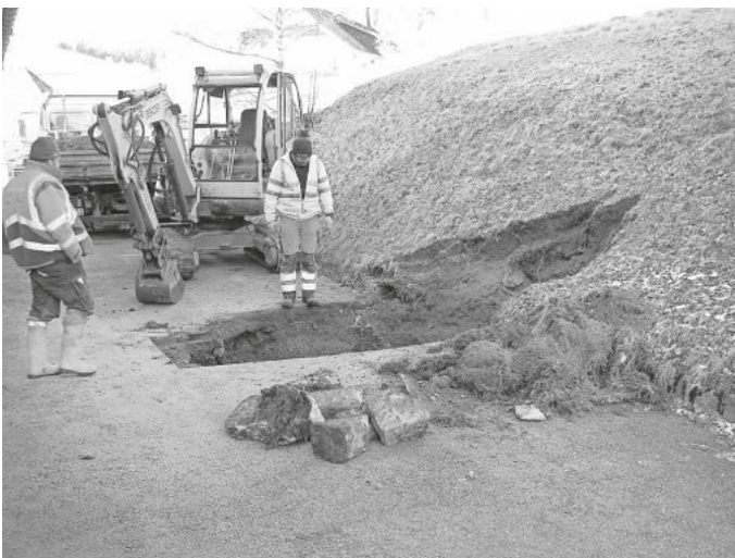
Rohrbruch Todtmoos- Strick vom 21.-23.01.2020, stündlicher Wasserverlust 900 l
